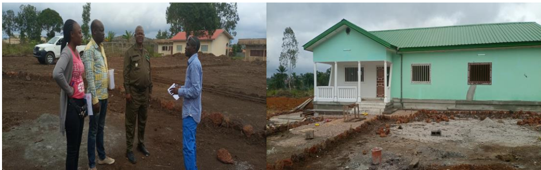
Visite du projet de construction du logement du Directeur départemental de l'Economie Forestière Lékoumou inscrit dans le cahier de charge général de l'entreprise SICOFOR
